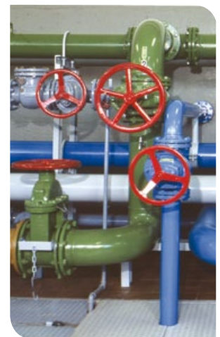
Rohrleitungen im Wasserwerk Waldow.
