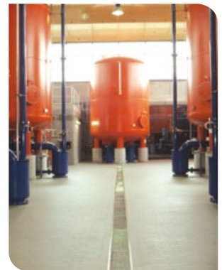
Wasserwerk Schwerin: Innenansicht mit Filtern.
